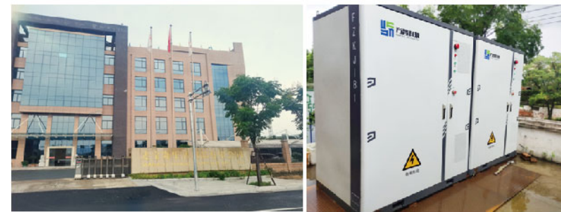
企业类型：生活用品 项目容量：0.2MW/0.4MWh
