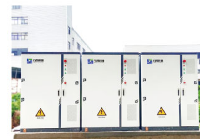
企业类型：滑动轴承制造 项目容量：0.3MW/0.6MWh
